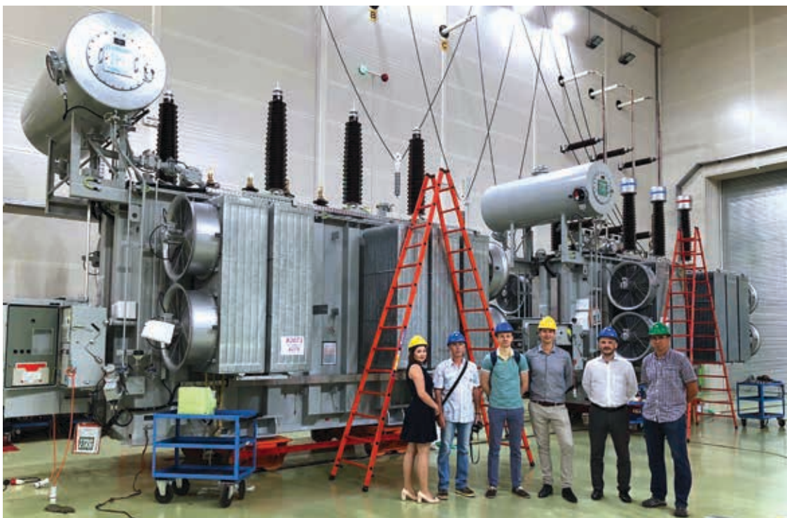
Prevzem prvih dveh transformatorjev v laboratoriju Kolektor Etre; z leve proti desni: Daria Tumanova, predstavnika elektrodistribucijske podjetja Rosseti, Matic Derglin, moja malenkost in dr. Nikola Jakšič.
